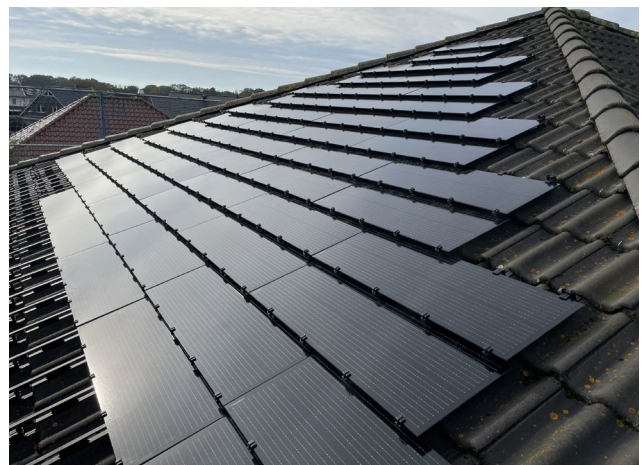
Le système SOLO sur le toit
